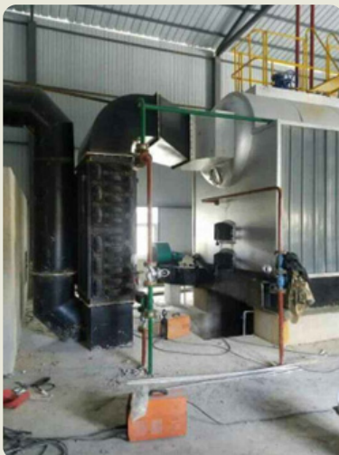
شکل شماره ۳: یک نمونه از دستگاه اکونومایزر نصب شده در صنعت
