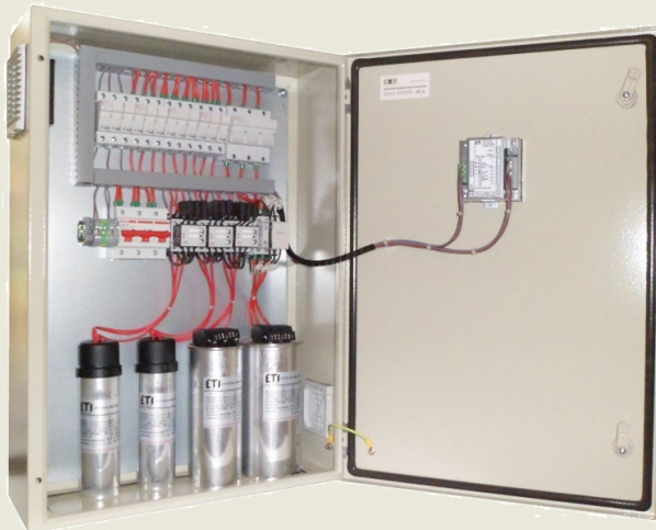
شکل شماره ۱۰: نمونه ای از تابلو برق بانک خازنی
