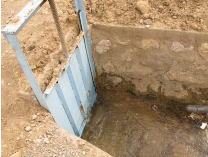
شکل ۱۲- نشت آب از زیر یک دریچه بسته
