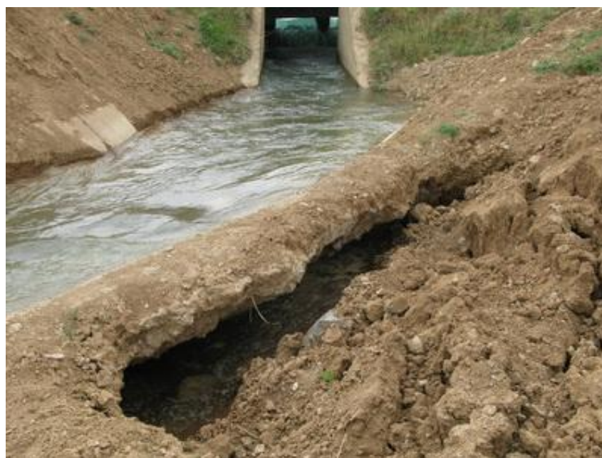
شکل ۱۱- نشست و فرسایش خاک در زیر کانال
