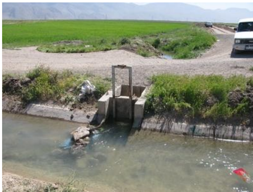
شکل ۹- نمایی از یکی از آبگیرهای مزرعه در شبکه آبیاری درودزن (تخریب دریچه و گذاشتن مانع در پایین دست)
